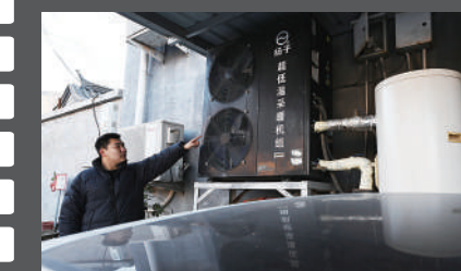
在立冬前门头沟韭园村空气源热泵设备已全部检修更换完毕
